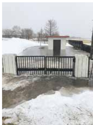
≪平成30年3月の融雪洪水の際に冠水した弟子屈原野の水道施設≫
