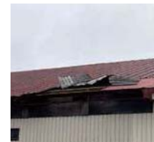
屋根の剥がれ
