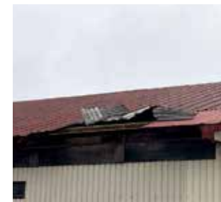
屋根の剥がれ
