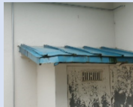
屋根破損(プロパン庫)
