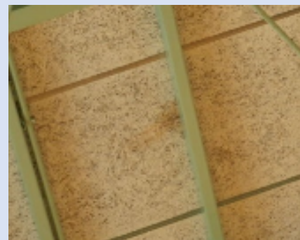
天井の雨漏り跡(体育館)
