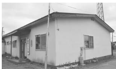
老朽化が進む施設
