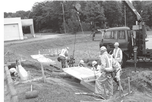
不安定で危険だった奥小学校庭前の階段を明盛建設の皆さんが改修
