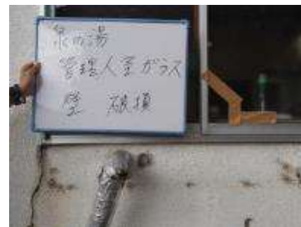
管理人室：ガラス窓・壁破損
