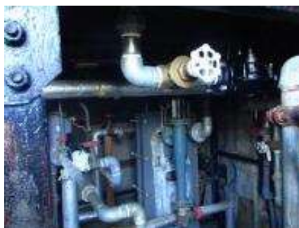
機械室：配管、バルブ、ポンプ等、 設備全体的に老朽化が激しい
