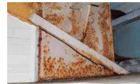
鉄骨：錆及び腐食
