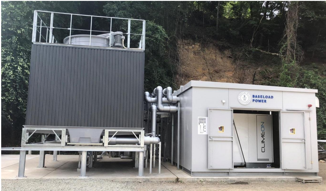
わいた第1.5発電所
